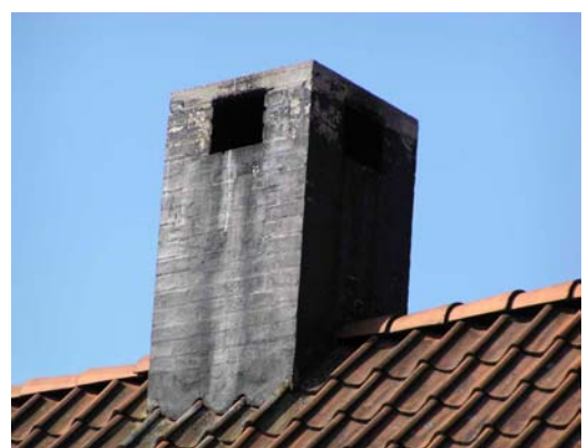
Skorstenstype med hvælv. Skorstenen ser ud til at være behandlet med kørnøg.
