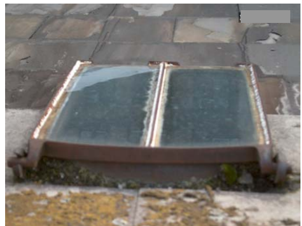
Gammelt tagvindue af støbejern med to enkeltlag glas lagt i kit. Tagvindue er tophængt og med udskyderstang forneden. Tagvindue er monteret i naturskiferbeklædning.
