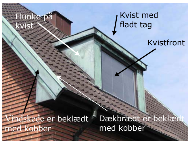
Mellemstort udhæng i facade og ved gavl.
