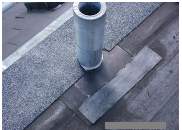
Faldstammeudluftning af zink, monteret i tagpaptag på 1. lag pap.
