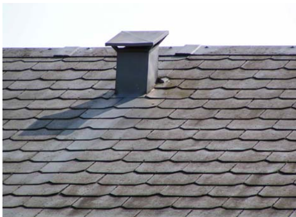
Udluftningshætte af zink, monteret i eternitskifertag.
